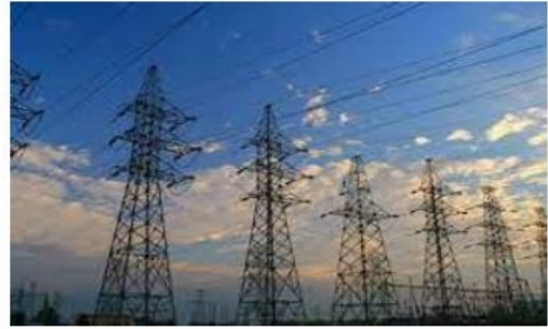
เสาไฟฟ้า
