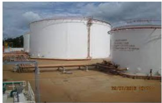
ถังเก็บน้ำมันเชื้อเพลิงบนดิน
